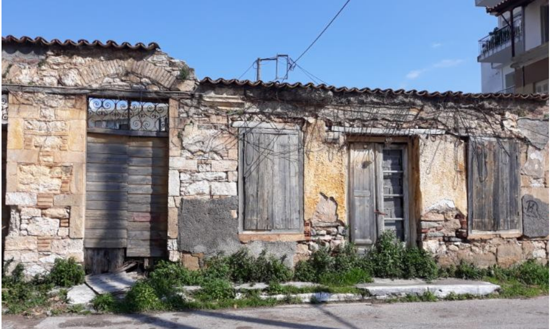
Το ερειπωμένο κτήριο όπου έκανε φροντιστήριο ο Μπάμπης Βασιλοπανάγος στην οδό Καπετάν Κρόμα
